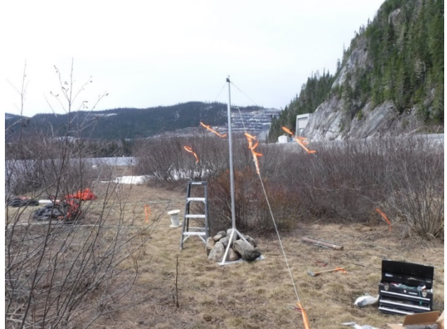
Photo 2 : Installation du mât pour le système d'enregistrement en continu SonTek IQ plus.
