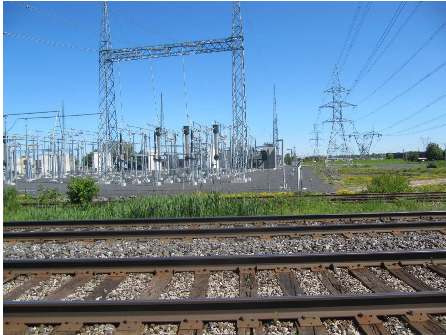
Figure 1 Vue du poste St-Bruno-de-Montarville de la route 116 vers la rue Marie-Victorin
