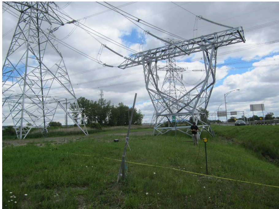
Figure 2 Vue du pylône permettant la dérivation des circuits 3007 et 3008 pour alimenter le poste St-Bruno-de-Montarville
