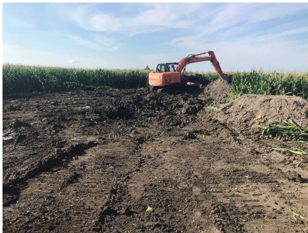
Remise en place des différentes strates de sols (sol arable en andain)
