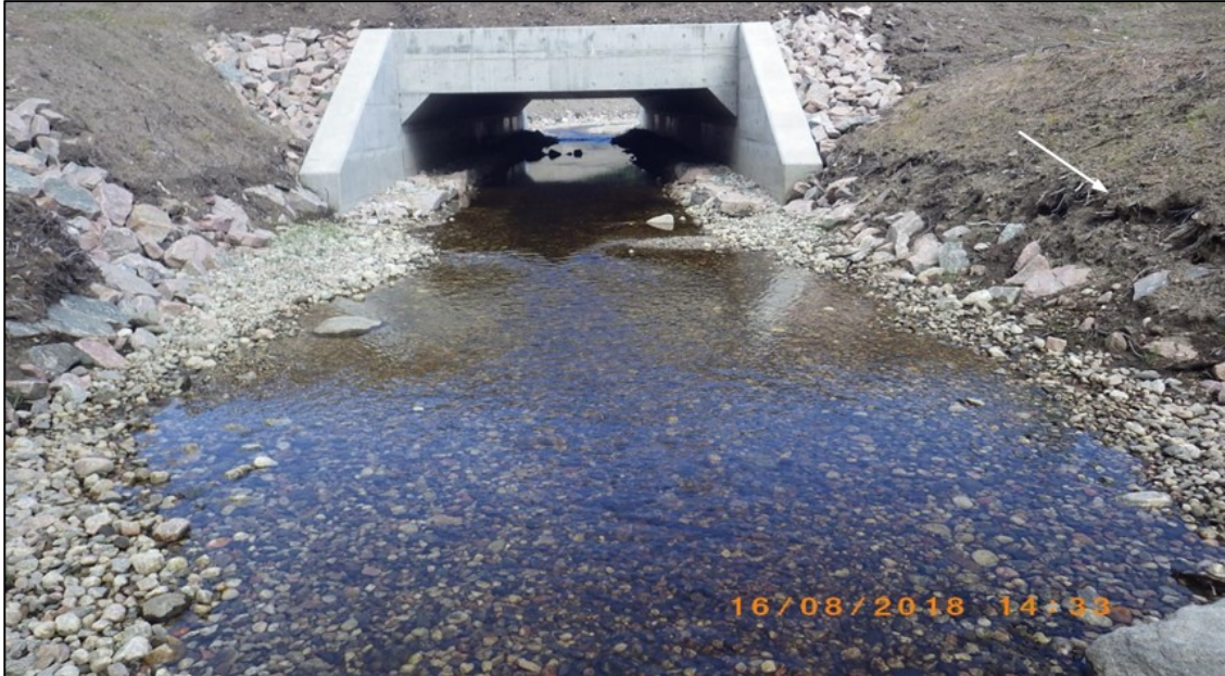
Photo 3 : Vue de l'aval, un peu d'érosion printanière est visible dans le haut de la berge en rive gauche, au-dessus de l'enrochement, mais seulement sur 6 m de long
