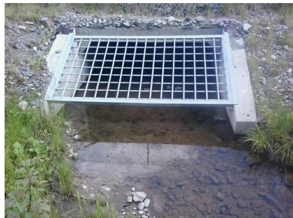
Fig. 5. Grille de protection d'un ponceau rectangulaire.
