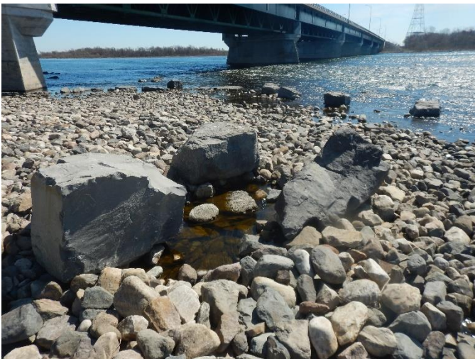
Photo 13 Dépression à la base de blocs-abris
