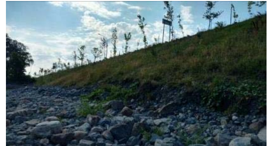
Photo 11 : Érosion en bas du talus
