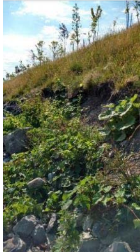
Photo 8 : Érosion en bas de talus (0+140)
