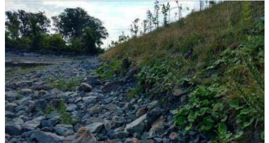
Photo 9 : Érosion en bas du talus (0+140)
