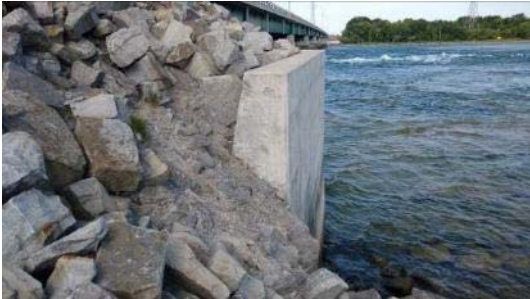
Photo: 7 Perrés déplacés (0+140)
