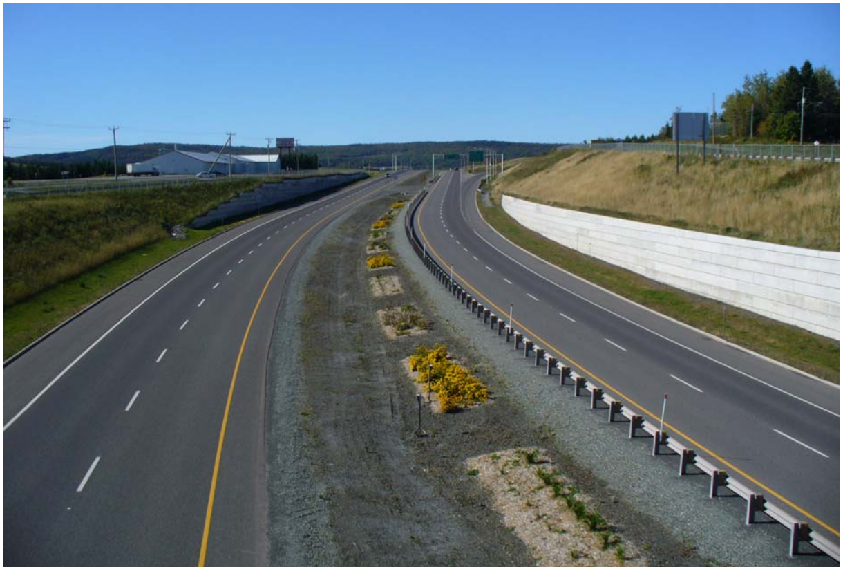
Photographie n°2.2 : Vue des nouvelles voies de l'autoroute au nord de la rue Raymond
