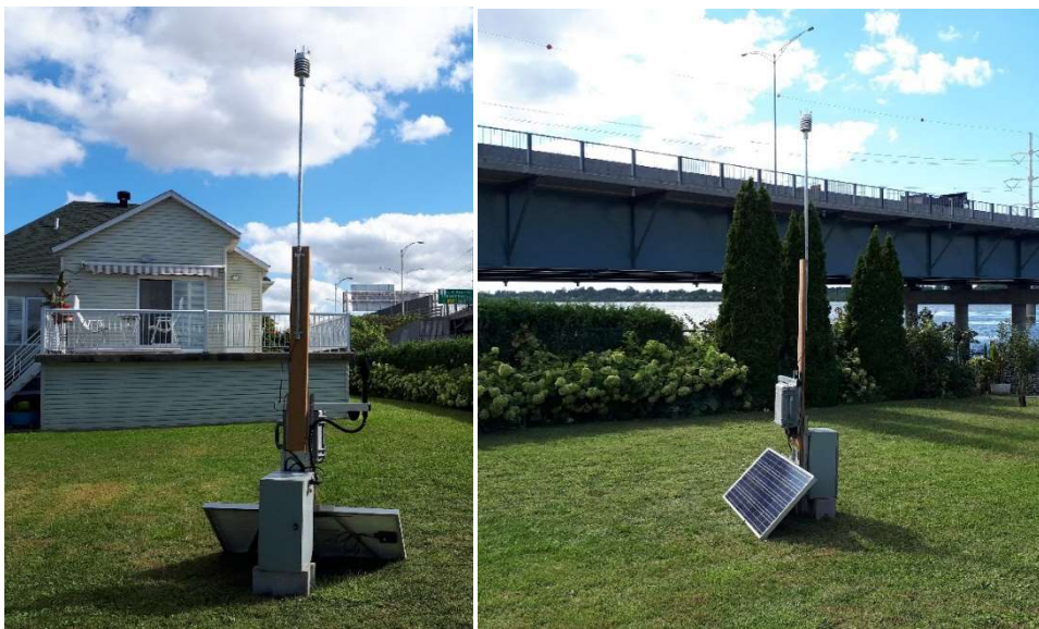
Figure 2 : Station installée à l'arrière du 7195 boulevard Gouin Est
