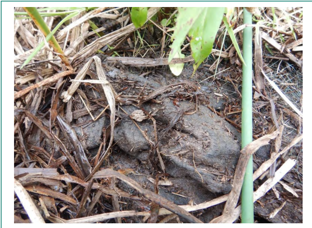
Photo 31 : Géotextile apparent dans la zone de l'étang
