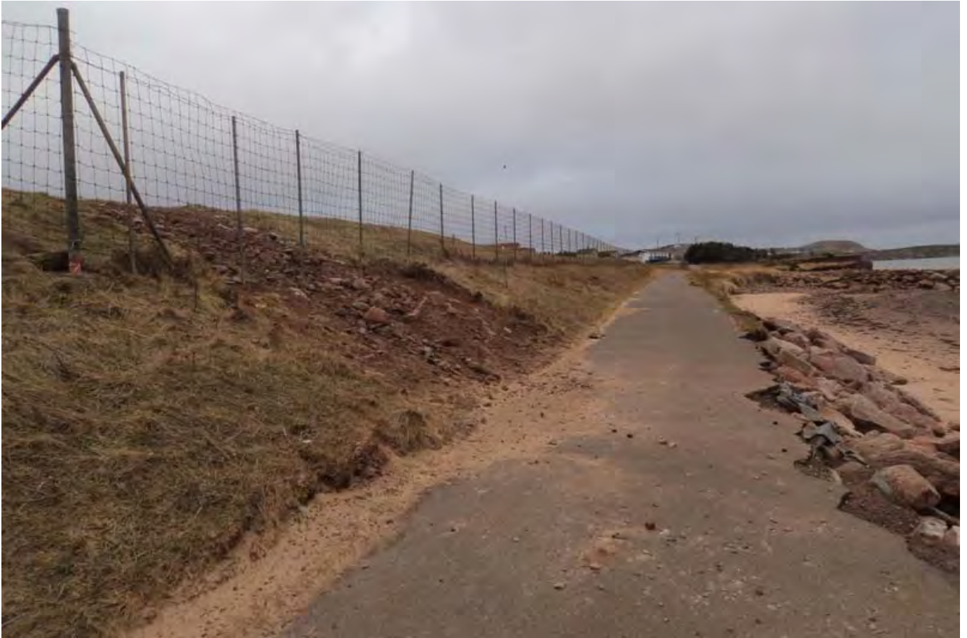
Figure 2.7 Érosion de la promenade le long des étangs aérés et effet du franchissement des vagues
