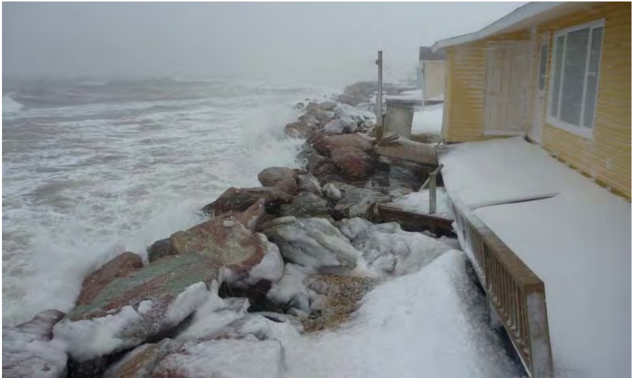
Figure 2.19 Chalets du secteur du chemin des Chalets– Tempête du 27 janvier 2011 – Les dommages constatés sur la galerie du chalet datent de tempêtes précédentes
