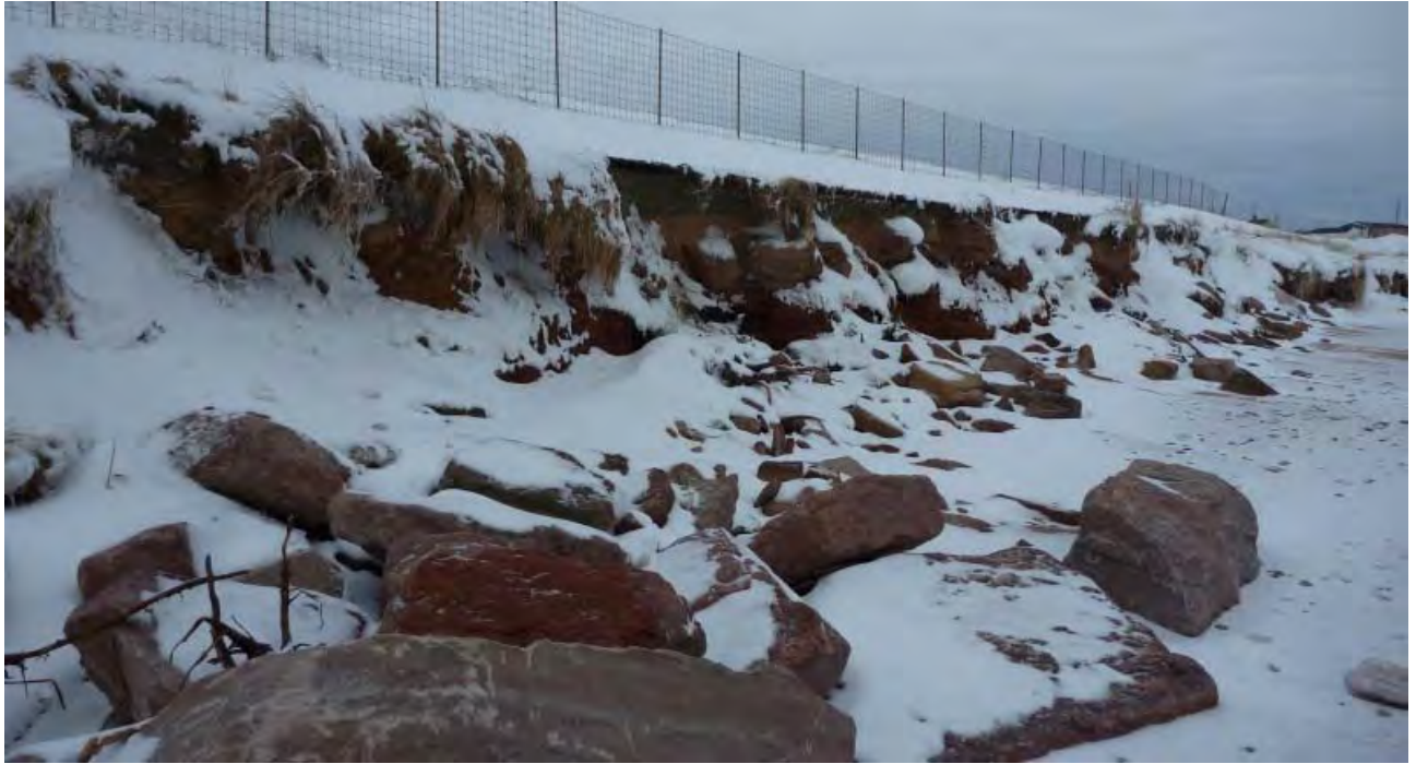
Figure 2.4 Secteur des étangs aérés – Érosion le long de la promenade
