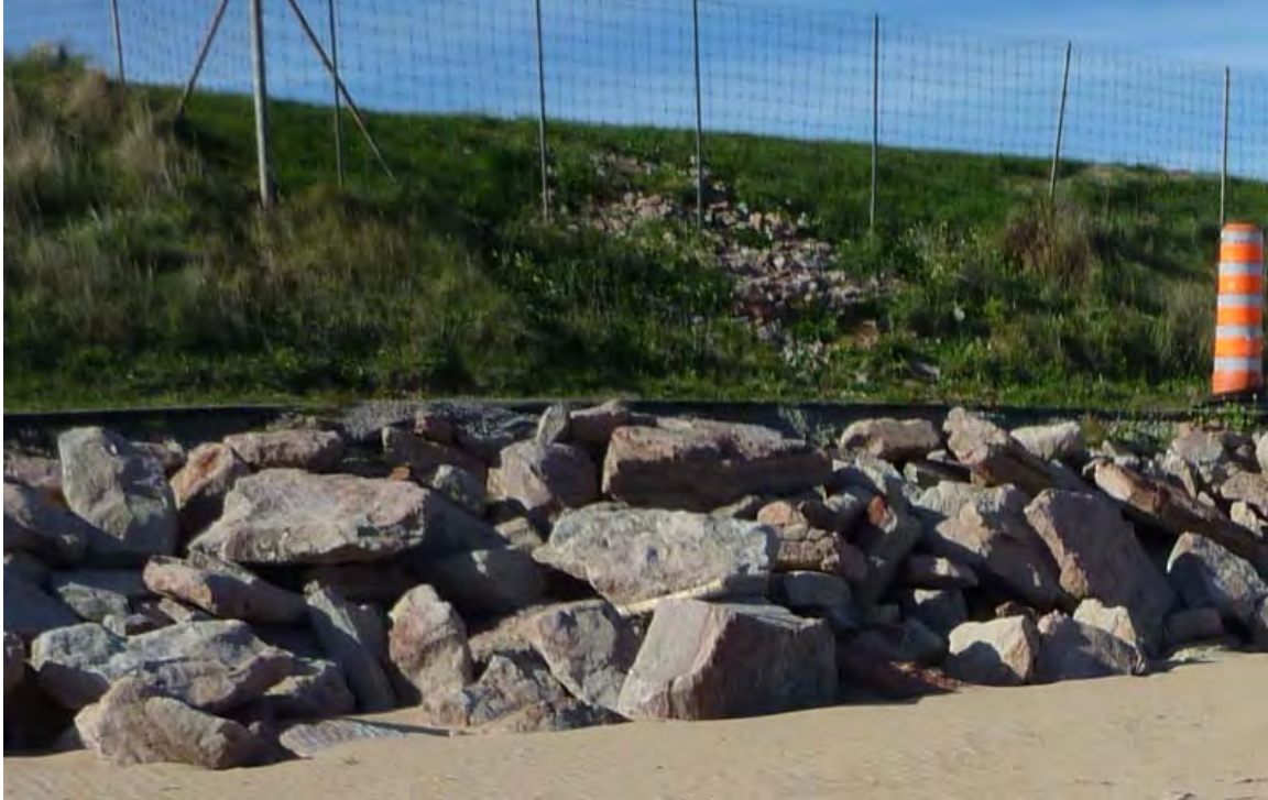
Figure 9.9 Dommage infligé par le franchissement des vagues sur le talus des étangs aérés
