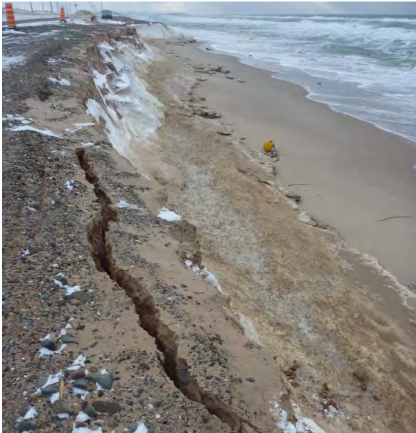
Figure 2.47 Fissure d'érosion dans le rechargement de plage au nord de Pointe-aux-Loups
