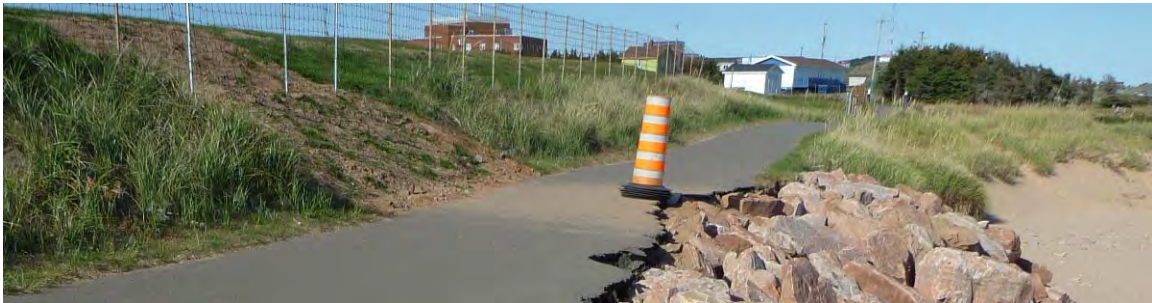
Figure 9.10 Dommage infligé par le franchissement des vagues sur le talus des étangs aérés
