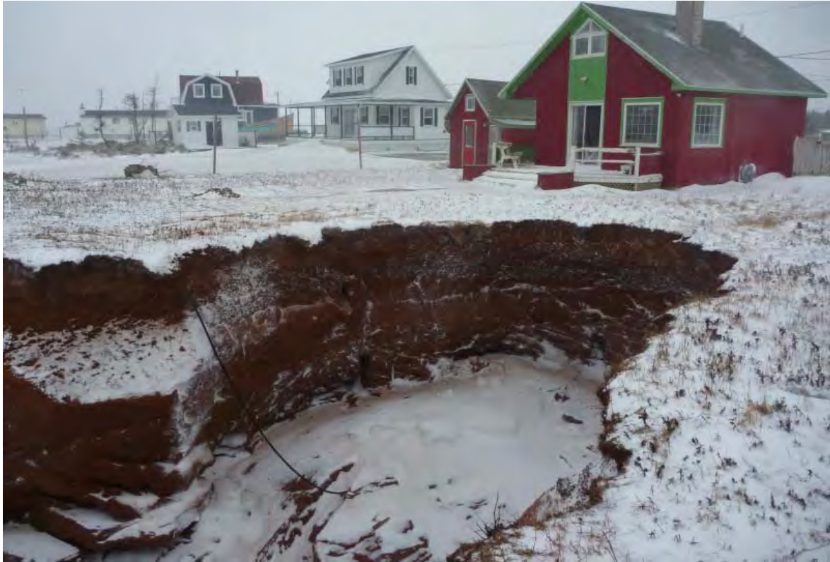
Figure 2.25 Pointe de la Martinique – Érosion de la falaise à proximité d'une maison
