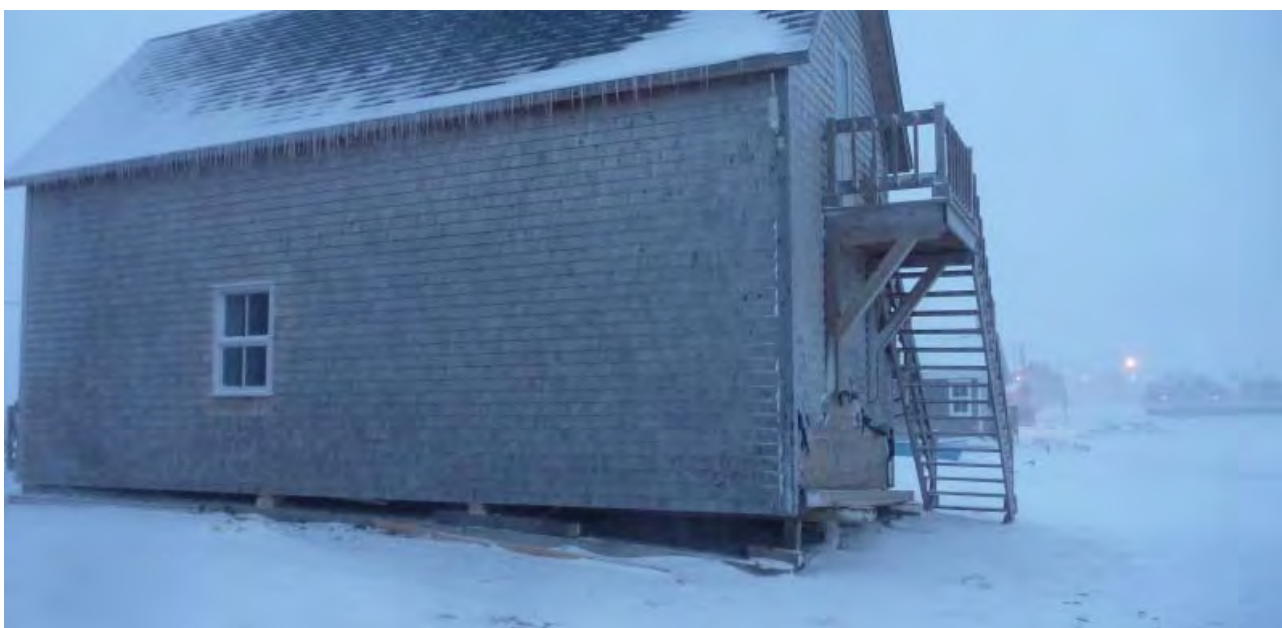
Figure 2.36 Fondation de bâtiment affaissée, suite à l'érosion de la plage
