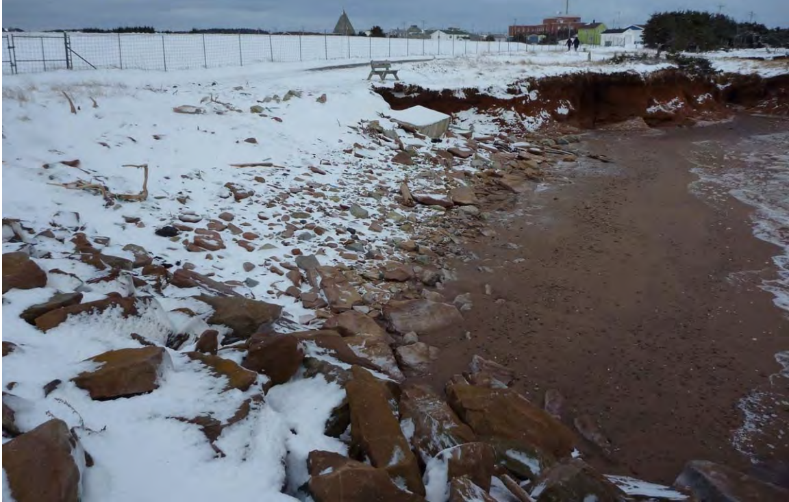
Figure 9.28 Plage de « galets » au nord de l'exutoire des étangs aérés (vu du dessus de l'exutoire)
