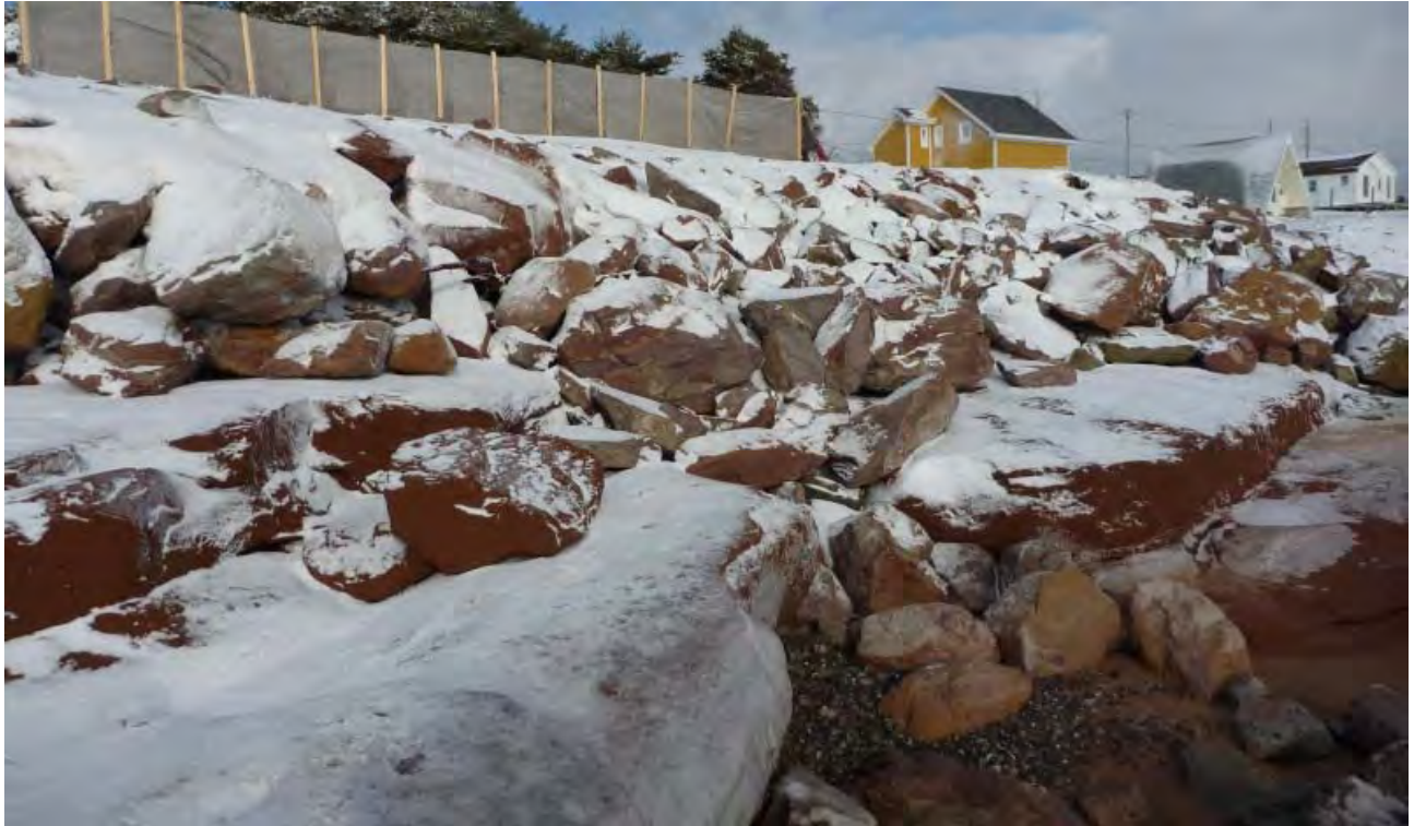
Figure 2.30 Pointe de la Martinique – Protection en enrochement dont le pied est instable (directement posé sur la roche sans butée)
