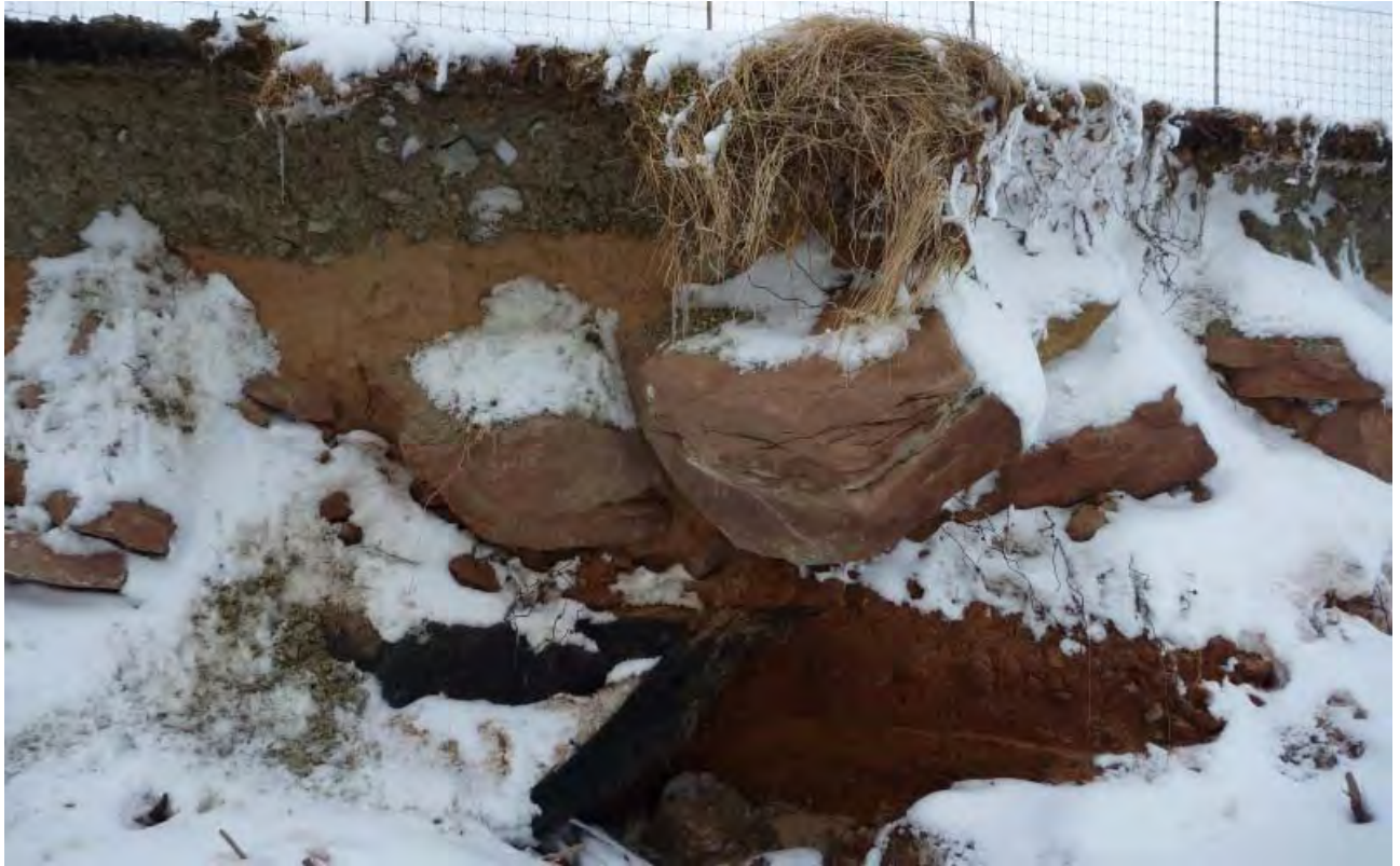
Figure 2.6 Secteur des étangs aérés – Vue rapprochée de l'érosion le long de la promenade
