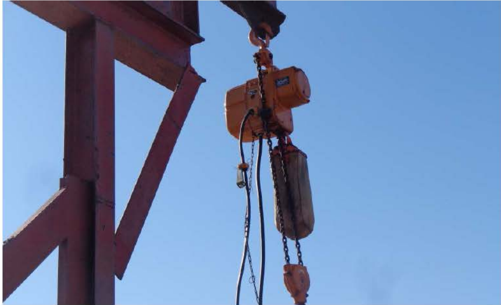
Figure 31 – Treuil non conforme
