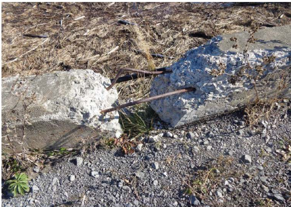
Figure 13 – Dégradation du béton et armature inadéquate
