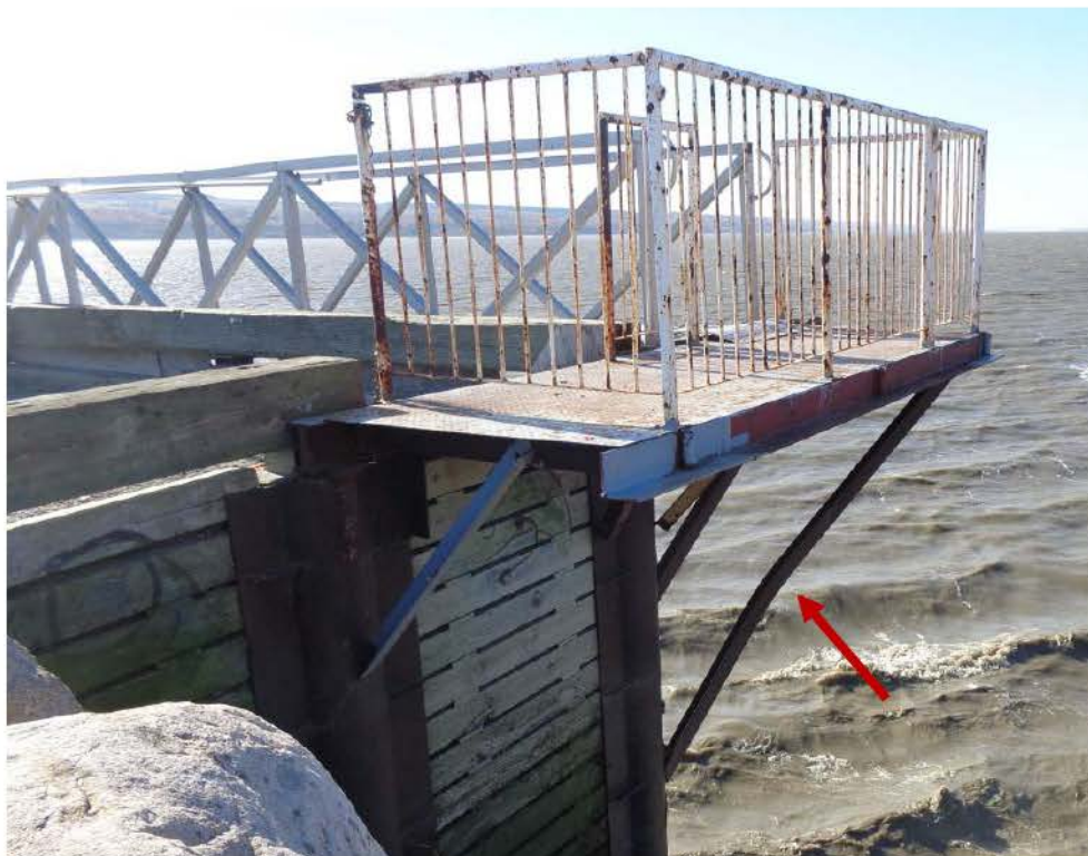
Figure 28 – Déformation aux membrures de support sous la section fixe de la passerelle
