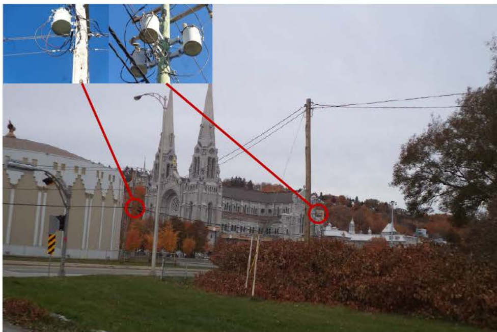
Figure 34 – Emplacement des transformateurs d'alimentation
