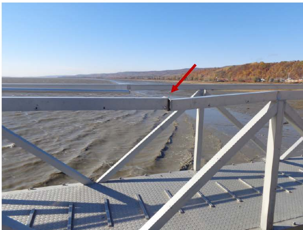
Figure 30 – Membrane supérieure de la rampe brisée et absence de la main-courante en grande partie
