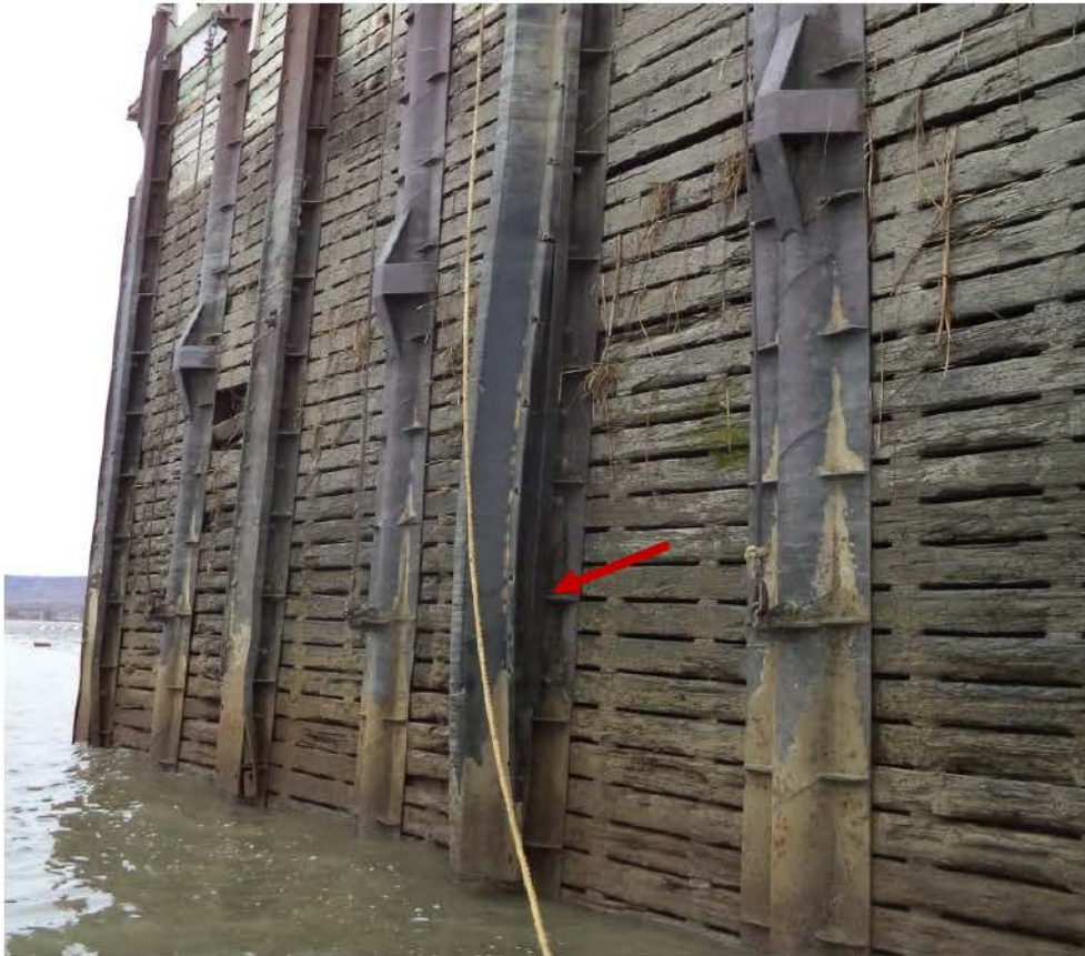
Figure 33 – Défense sur le pieu 14
