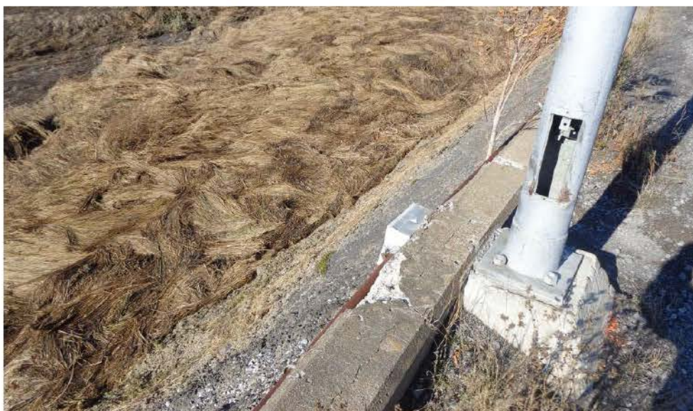
Figure 38 – Absence des câbles d'alimentation dans un fût de lampadaire
