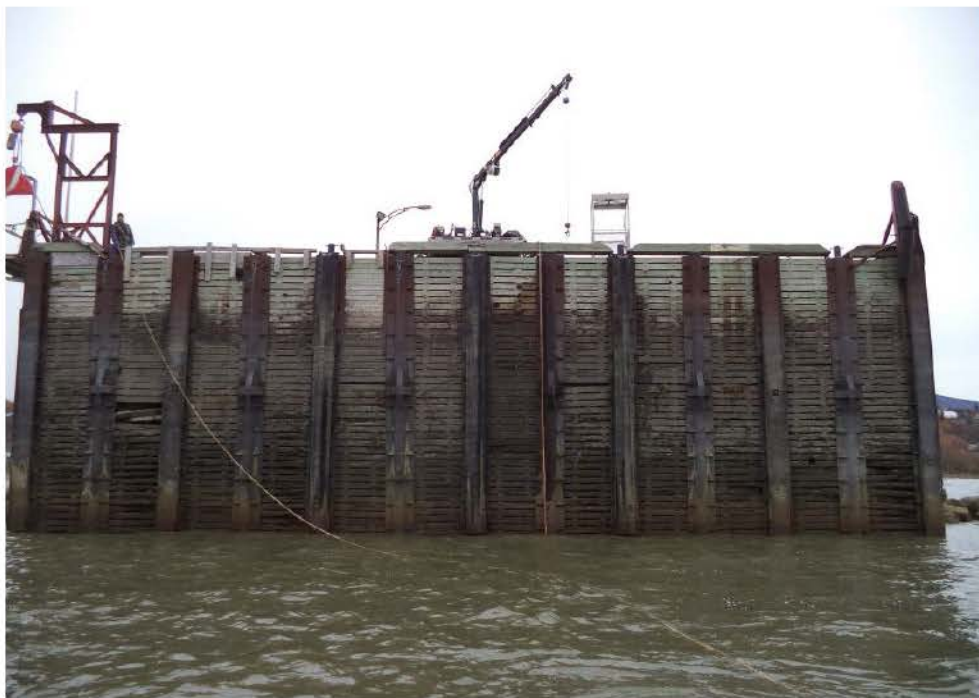
Figure 21 – Nombreux désordres observables, côté sud
