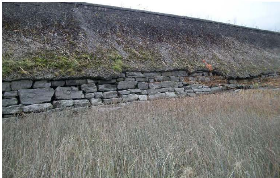
Figure 10 – Disparition du béton maigre au pied du muret
