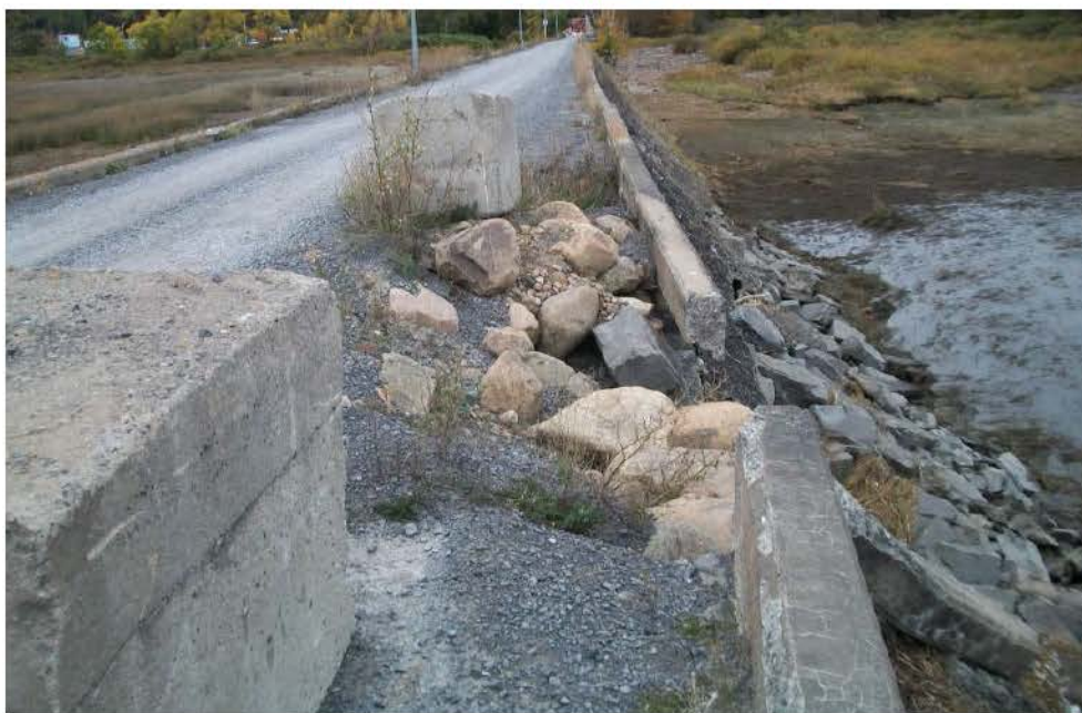
Figure 18 – Affaissement du côté nord de la digue
