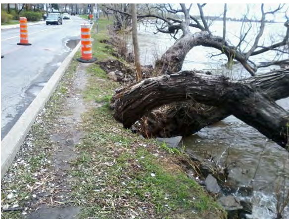
Photo 3 : Segment 42 – Effondrement de la berge à moins de 2 m du chemin du Bord-du-Lac – Lakeshore (photo prise le 6 mai 2017).
