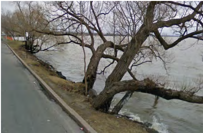
Photo 1 : Segment 42 – État de la berge requérant des interventions à moyen terme (photo provenant de Streetview – avril 2009).
