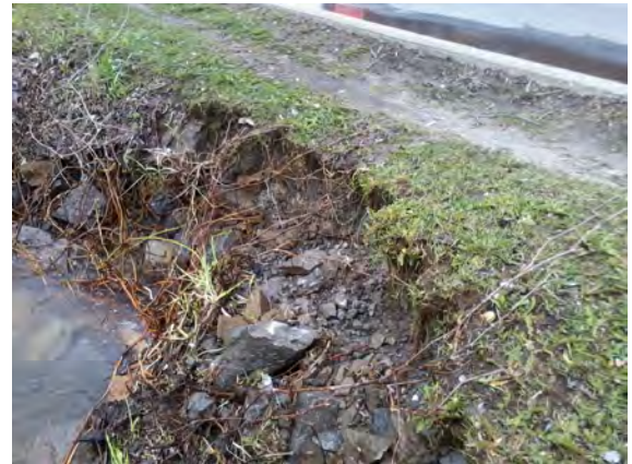
Photo 2 : Segment 42 – Effondrement de la berge à moins de 2 m du chemin du Bord-du-Lac – Lakeshore (photo prise le 6 mai 2017).
