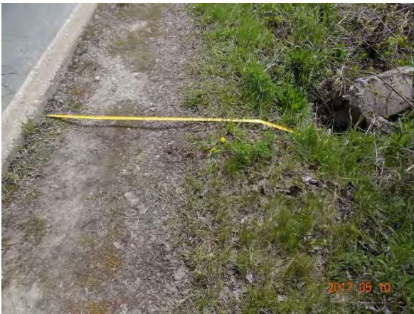
Photo 9 : Segment 51 – Effondrement de la berge à moins de 2 m du chemin du Bord-du-Lac-Lakeshore (photo prise le 10 mai 2017).
