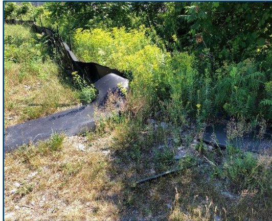
PHOTO 2 – Dommage clôture – Aire d'entreposage
