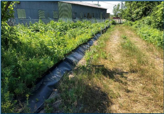
PHOTO 3 – Dommage clôture – Aire d'entreposage
