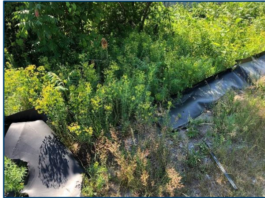
PHOTO 4 – Dommage clôture – Aire d'entreposage
