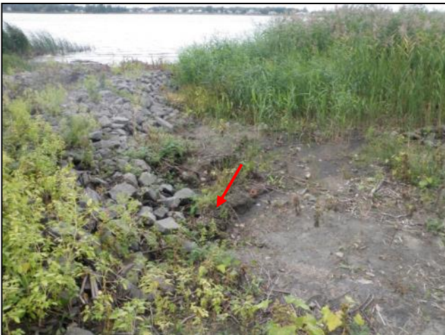
Photo 43 Signes de ruissellement du côté est du stormceptor. (25/09/2015)
