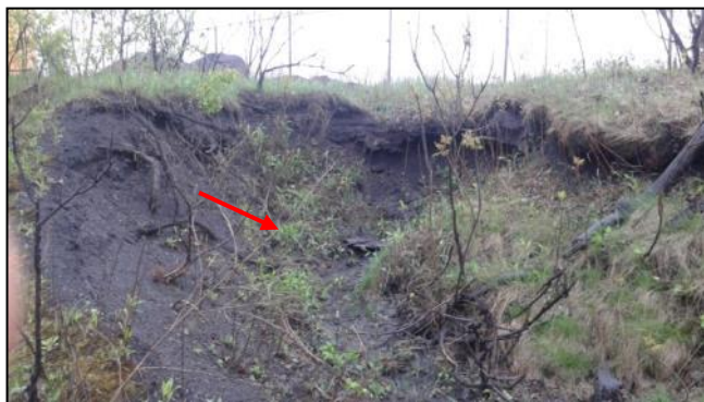
Photo 9 Affaissement du talus entre la clôture de RTFT et la berge dans le secteur du piquet 3. (11/05/2015).
