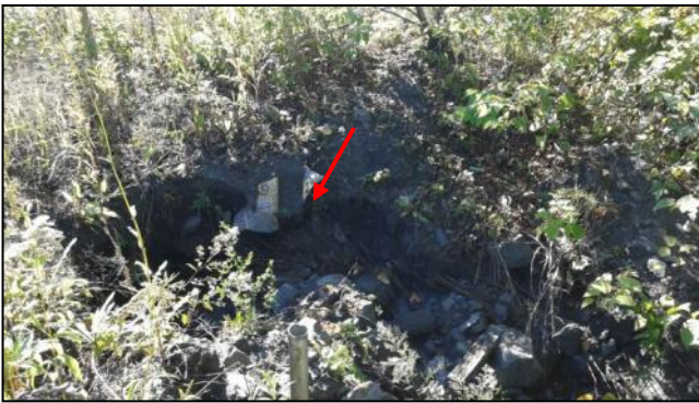
Photo 41 affaissement dans le haut du talus, entre les piquets 4 et 5. (25/09/2015)
