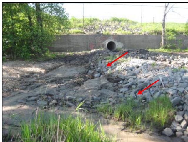
Photo 8 Une partie des bourrelets de pierres du côté est du stormceptor est toujours visible. (02/06/2015)
