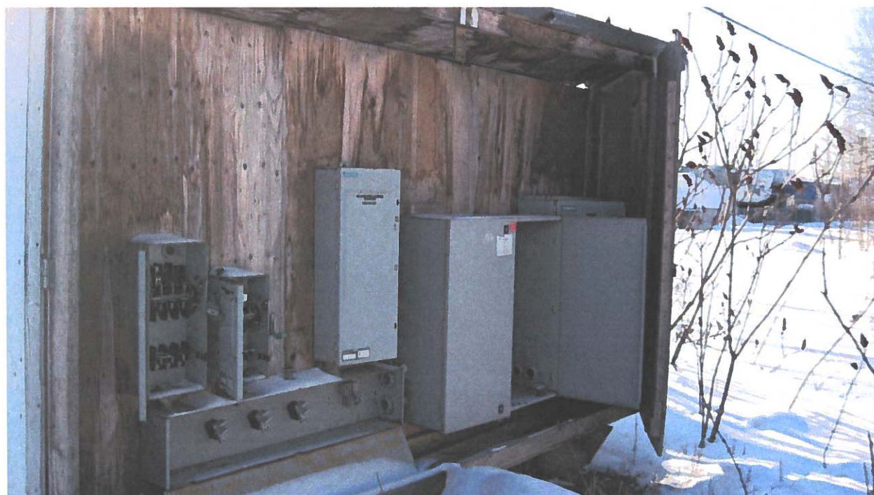
Photo 7a Vestige des installations électriques utilisées lors de la réhabilitation environnementale (Ancien dépôt de Esso - section 4).
