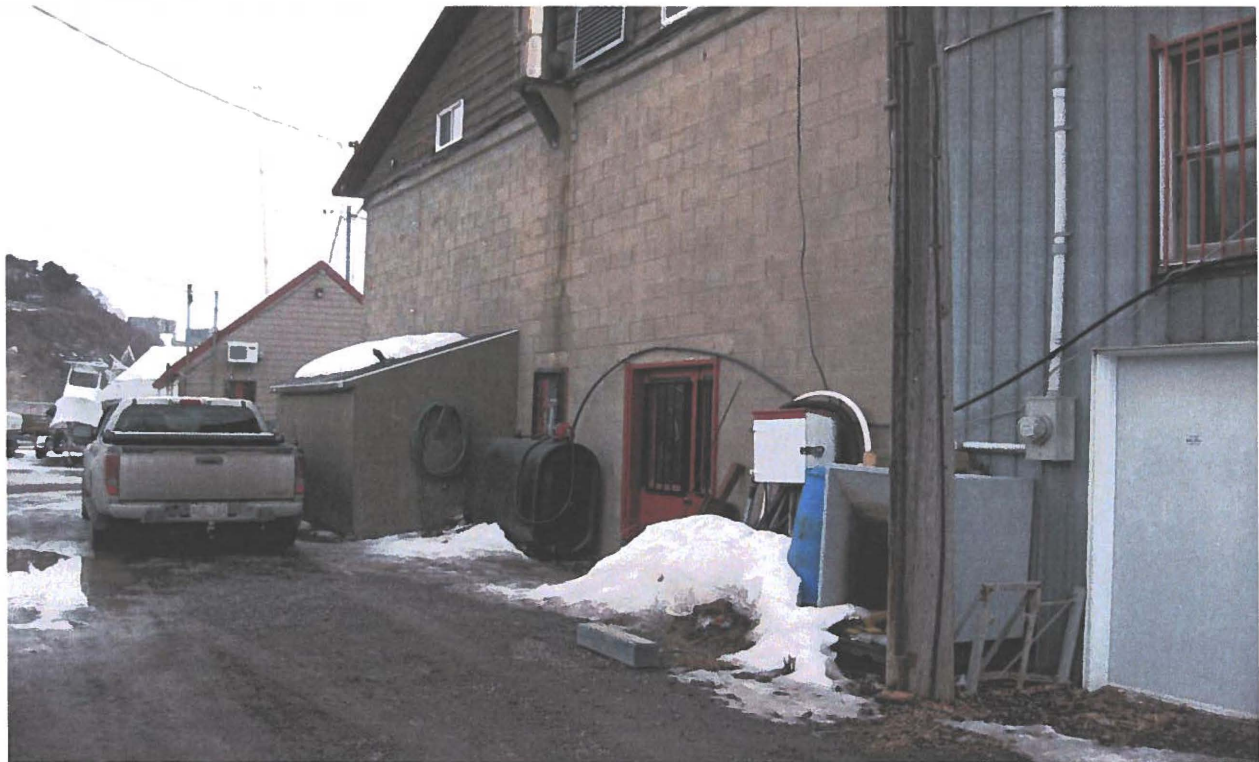
Photo 3 Réservoir extérieur de diesel.
