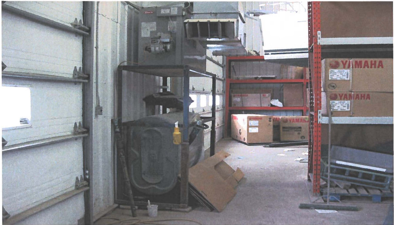
Photo 2 c Réservoir intérieur d'huile à chauffage (portes 4 et 5).
