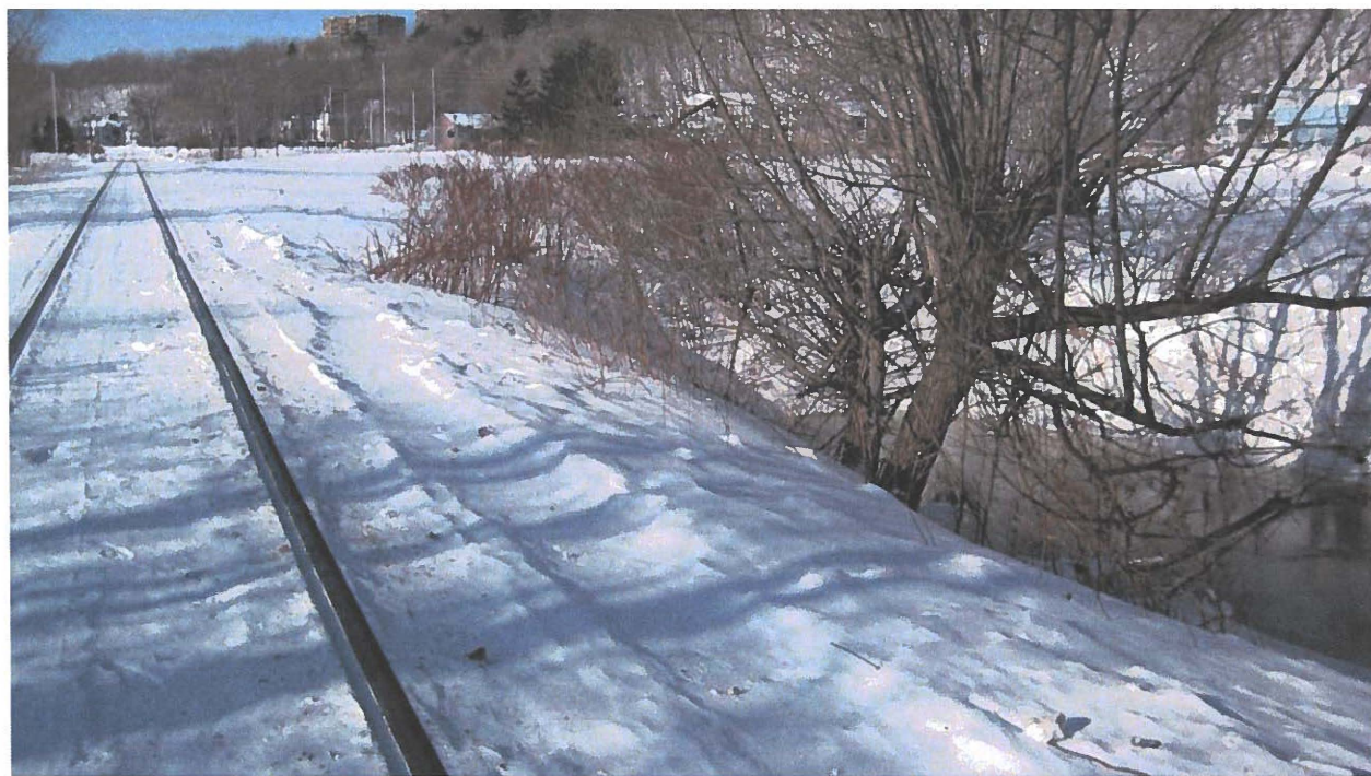
Photo 11 Accumulation d'eau en bordure de la voie ferrée (section 1). Vue vers l'ouest.
