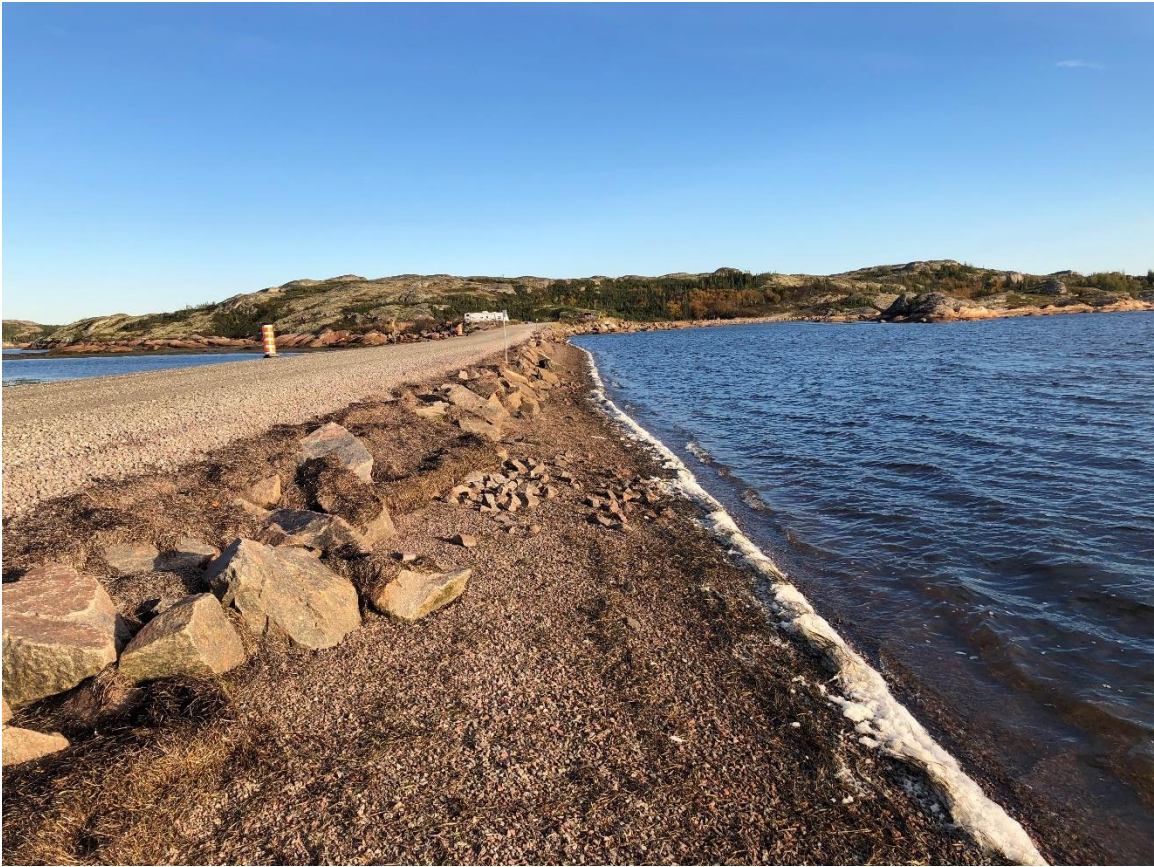
Photo 1. Ligne supérieure de débris et coloration de la pierre du talus dans le tronçon 1
