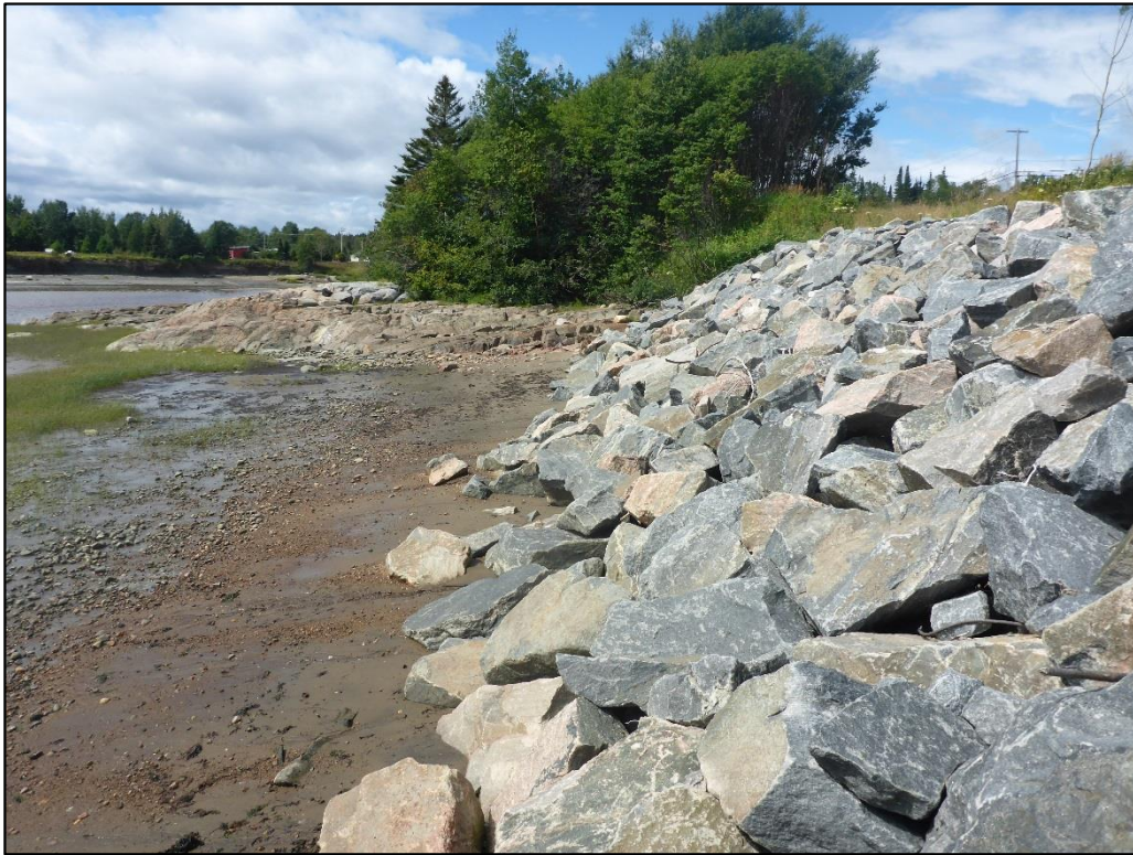
Photo 7. Enrochement à l'emplacement du quadrat 11Q1 (auparavant herbier 11H2)
