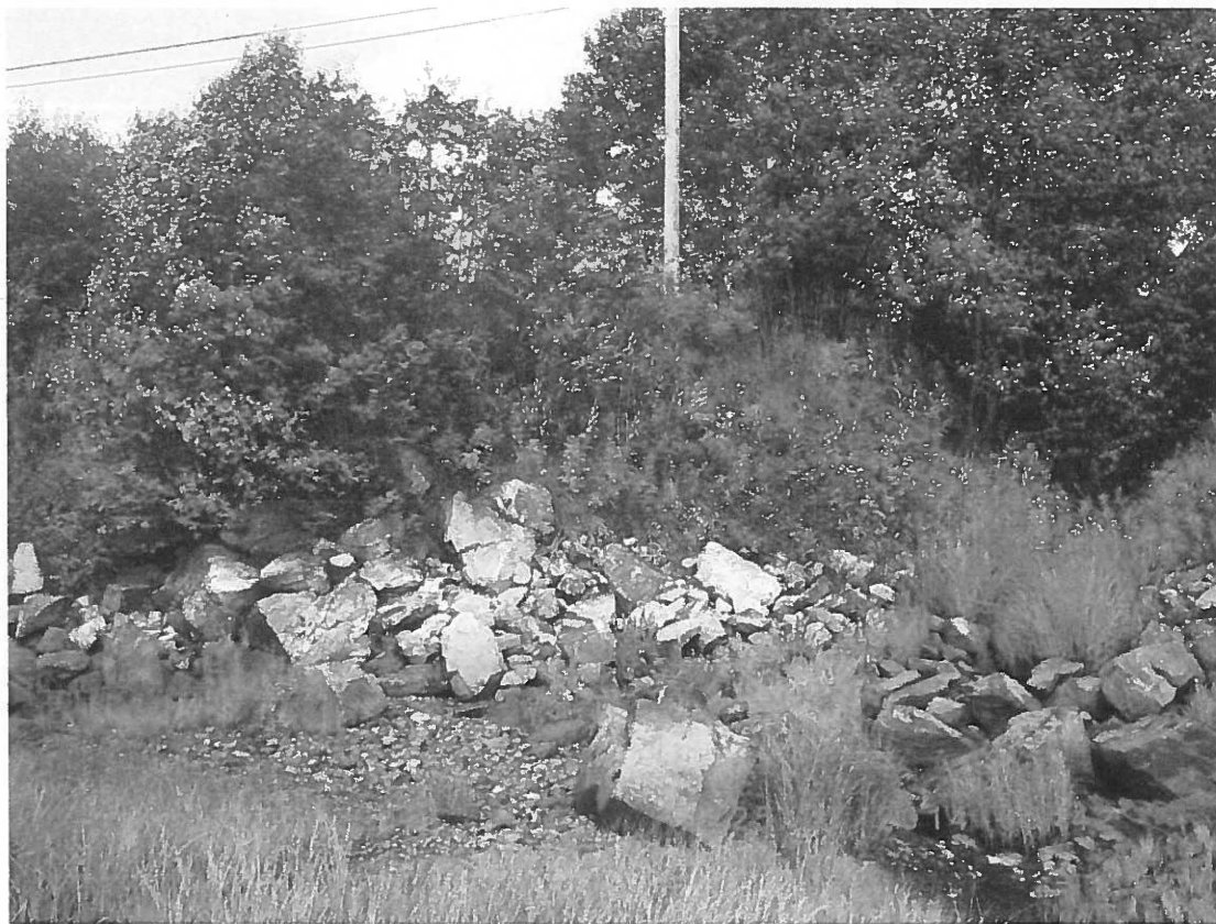
Photo 8 : RAG-6, protection en pierres, possiblement déversées qui continue de protéger le poteau de services publics.
