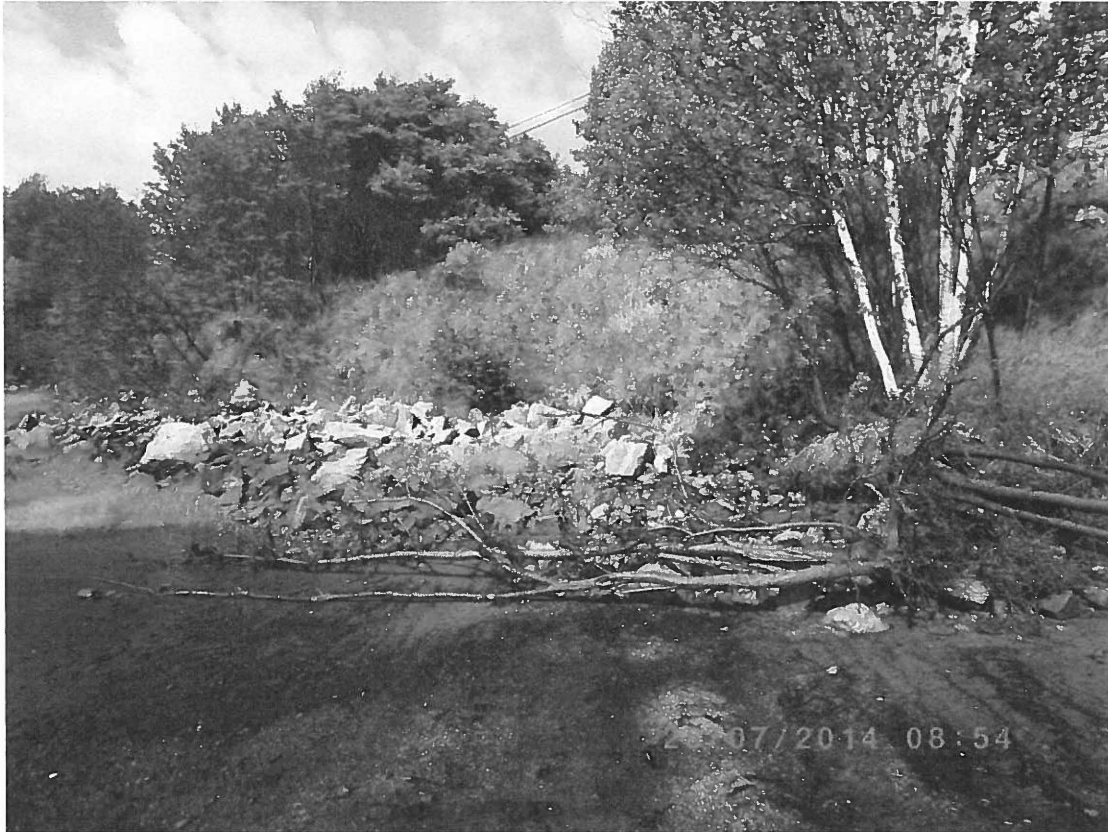
Ptoto 11 : RAG-6, enrochement existant qui apparaît toujours efficace à l'extrémité Ouest de la zone érodée compte tenu qu'aucune évidence d'érosion de talus n'est observée.
