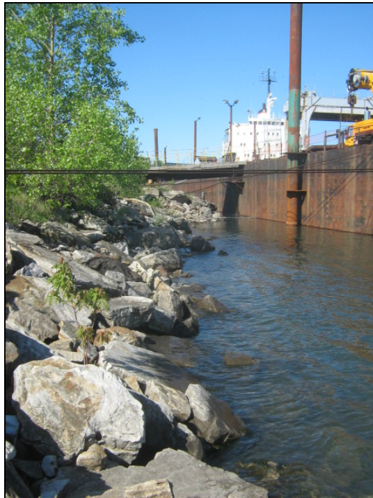
Photo n° 3 : Axe 1 de la berge. Vue en direction ouest. Quai de juridiction fédérale. (2017-10-26)
