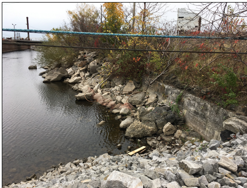
Photo n° 2 : Axe 1 de la berge. Vue en direction est. Quai de juridiction fédérale. Présence d'un muret de béton. (2013-05-27)
