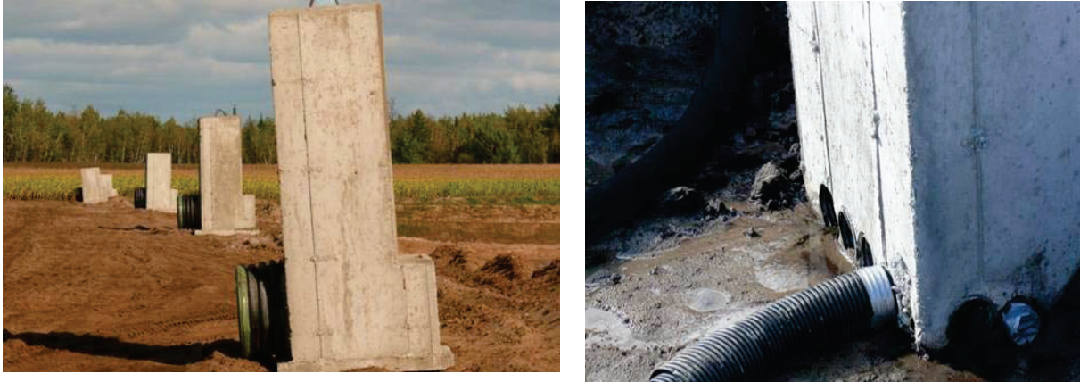
Figure 11. Structure de contrôle de nappe phréatique
