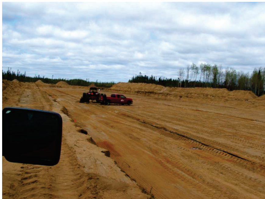
Figure 4. Bassin avec amoncellement de sable disposé le long de celui-ci
